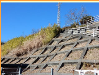
富士市富士岡入町の急傾斜地のひび割れや除草などについて調査。県は計画的に対処するとした。
