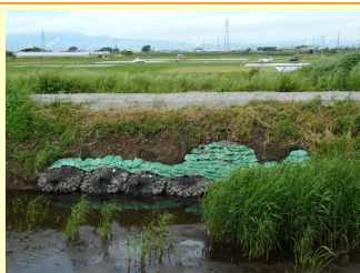
富士市東部の春山川下流域の土手が崩れた現場を調査。県は応急処置を行ったが、今後の対策を協議。
