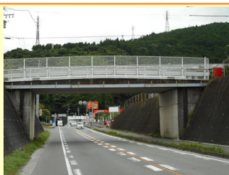
南松野地区、県道沿いの側溝不備により、県道内の水たまりによる交通事故発生防止対策として、恒久対策を検討。
