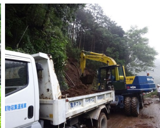
大畑の滝に向かう市道沿いで崖崩れが発生。
