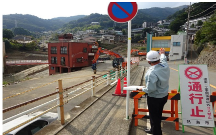
SNS等で発信された被災現場で、現在の復旧状況を説明する県職員。
