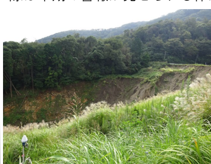
熱海市伊豆山地区土石流災害が発生した源頭部にある盛り土を視察。
